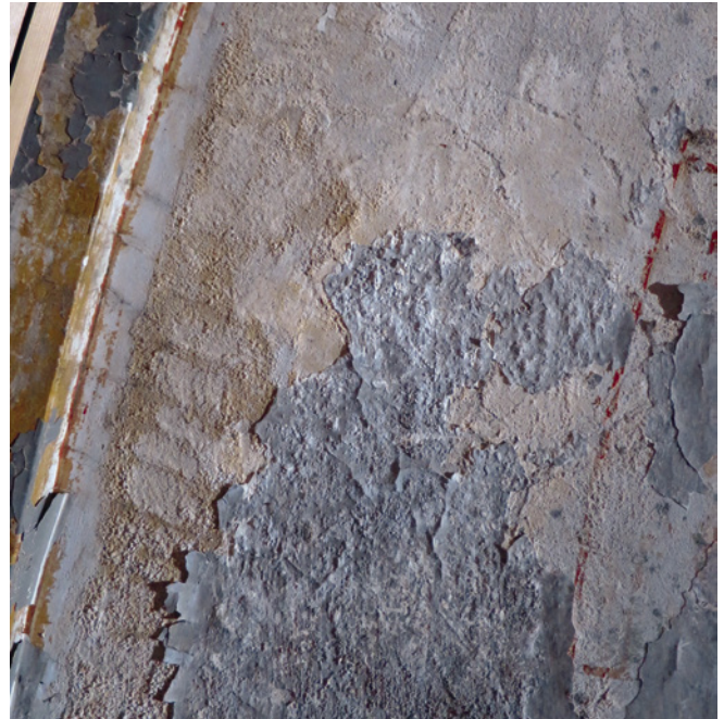
Diverse soorten schade bij elkaar: zoutuitslag, scheuren en verf die bladdert en verpoedert
