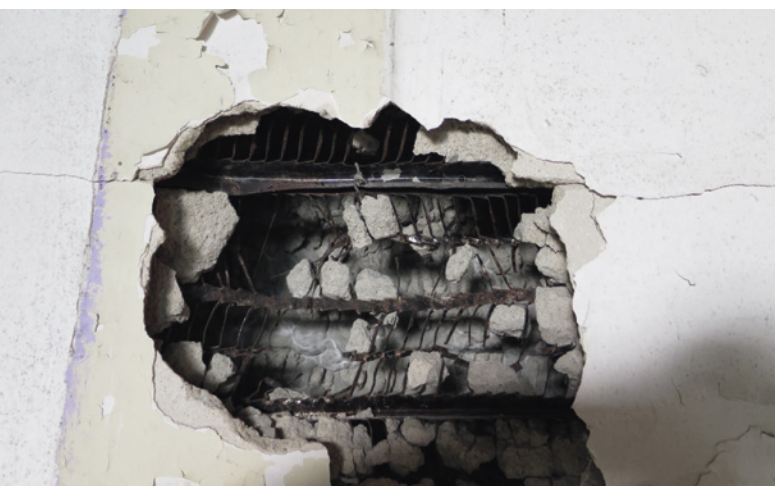
Een wand opgebouwd uit een houten raamwerk met daarop ribbenstrekmetaal als drager voor het stucwerk
